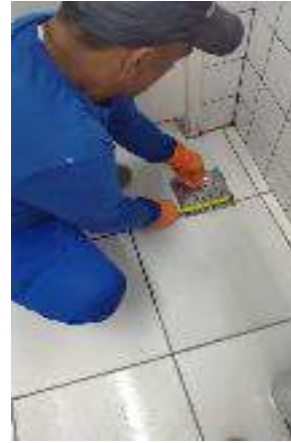
Figuras 09: Levantamento dos ralos danificados na unidade.
