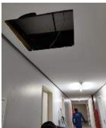
Figura 03: Abertura em gesso do corredor térreo para passagem de fiação para circuito elétrico;
