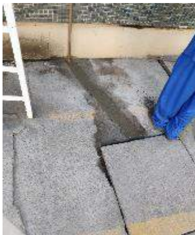
Figura 04: Passagem do cano de captação da água do ar condicionado;
