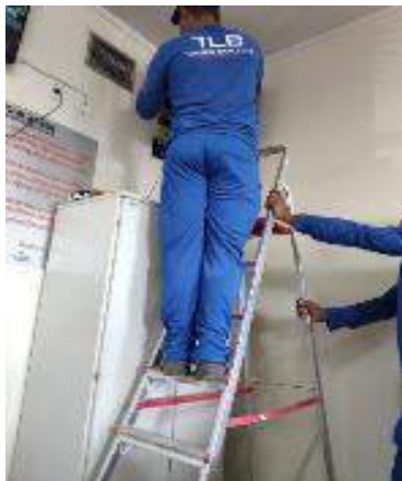
Figura 03: Remoção de suporte para televisão danificado na recepção de doadores;
