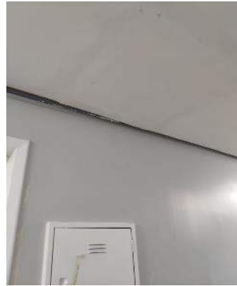
Figuras 02: Reparo com massa pva no teto do corredor principal no primeiro piso;
