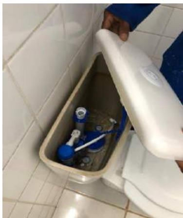
Figura 07: Após identificar em dois vasos sanitários, caixas acopladas danificadas, foi feito a instalação de novos kits;
