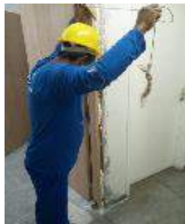
Figura 06: Tirando prumo da porta na sala do TI;
