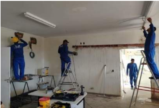
Figura 01: Rasgo em alvenaria para passagem de rede frigorígena na recepção de doadores;
