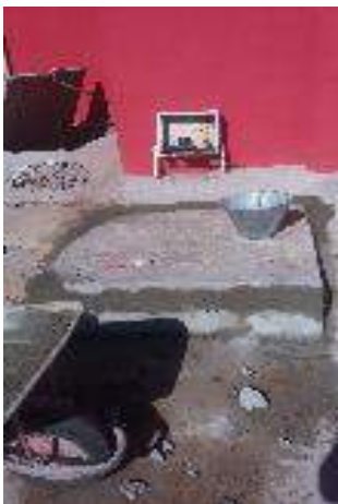
Figura 04: Após reconstituição do fundo da caixa de esgoto, a mesma foi lacrada com argamassa;
