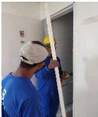
Figura 05: Fixação do alisar no portal do banheiro masculino na ala farmaceutica da unidade;
